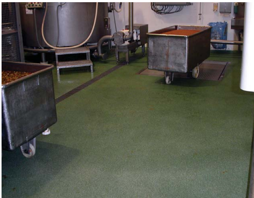
Метилметакриловое покрытие Duragon® толщиной 10 мм, консервный завод BUSS (Бремен, Германия), 25 лет в эксплуатации!
