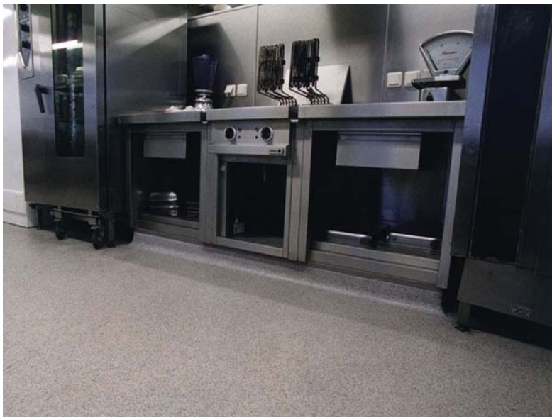
Метилметакриловое покрытие Duracon® толщиной 6 мм, промышленная кухня, перерабатывающий завод EFA (Люксембург), 8 лет в эксплуатации
